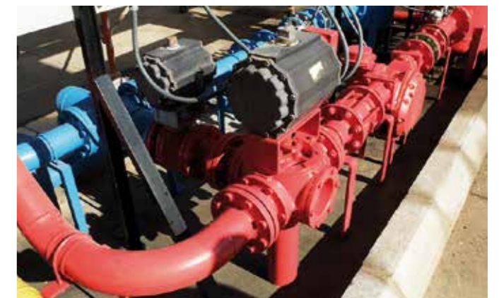
Válvula para carga de combustible Fueling valves
