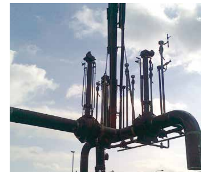
Línea de gas Gas pipeline
